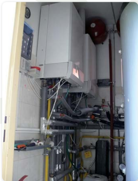
Technologické zariadenie – výmenníky
