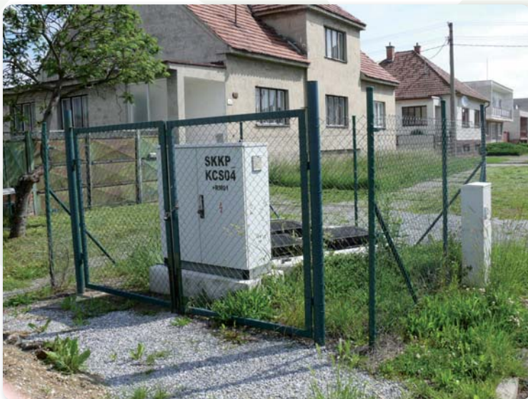
Kanalizácia s prečerpávacou jednotkou
