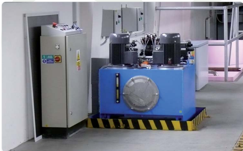
Pohľad na nové čerpadlo
