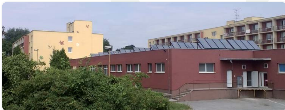
Umiestnenie solárnych kolektorov na budove domova dôchodcov
