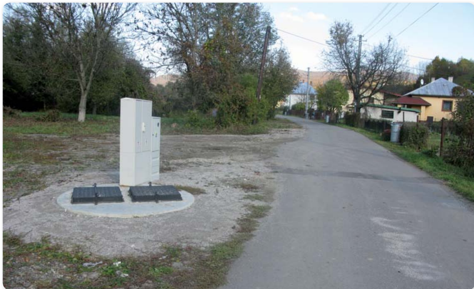
Prečerpávacia stanica odpadových vôd
