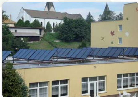
Pohľad na solárne panely
