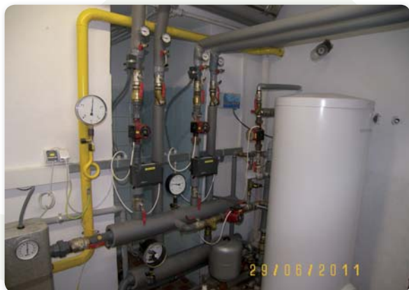
Technologické zariadenie kotolne
