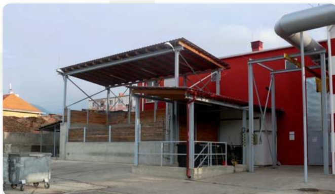
Pohľad na kotolňu a zásobník na biomasu
