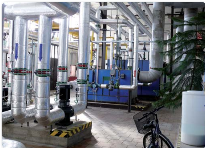
Technologické zariadenie kotolne na biomasu
