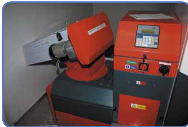
• Zariadenie pri spaľovaní biomasy
