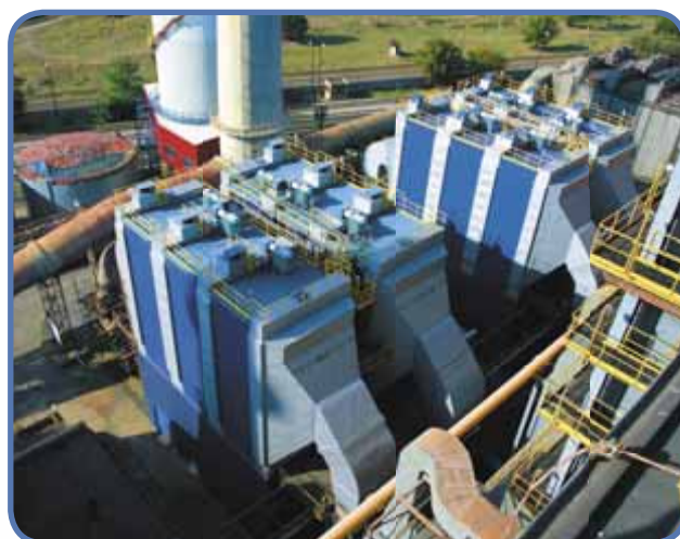
• Pohľad na elektrostatické odľučovače za parnými kotlami PK3, PK4
