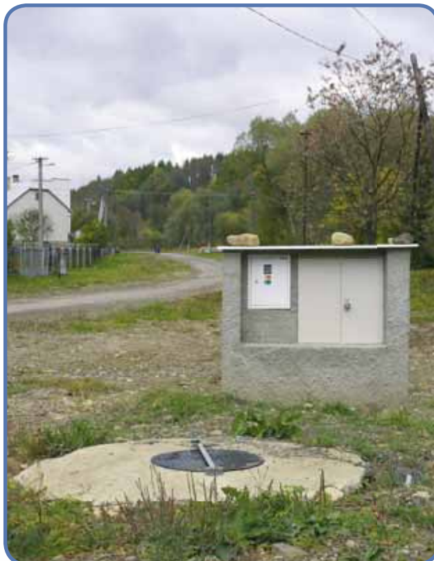
• Kanalizácia s prečerpávacou jednotkou
