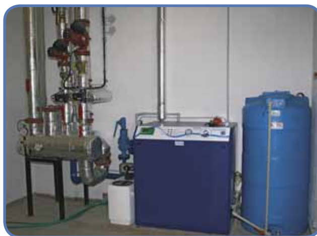
• Technologické zariadenie kotolne Foto: Dušan Reinart
