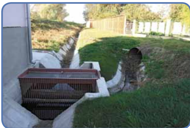
• Zberná šachta pri čerpacej stanici
