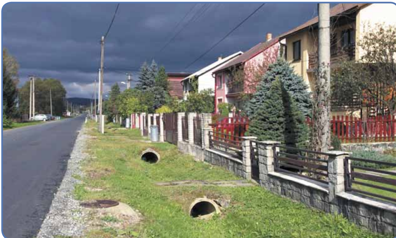
• Časť kanalizácie vedúcej cez obec
