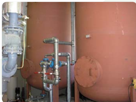
Technologické zariadenie kotolne
