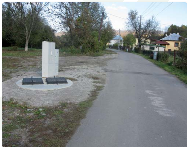
Prečerpávacia stanica odpadových vôd
