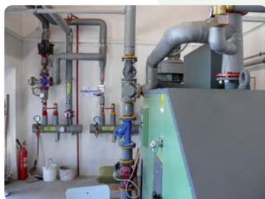
Pohľad na technologické zariadenie kotolne na biomasu
