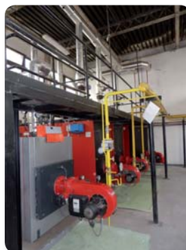
Technologické zariadenie kotolne na biomasu
