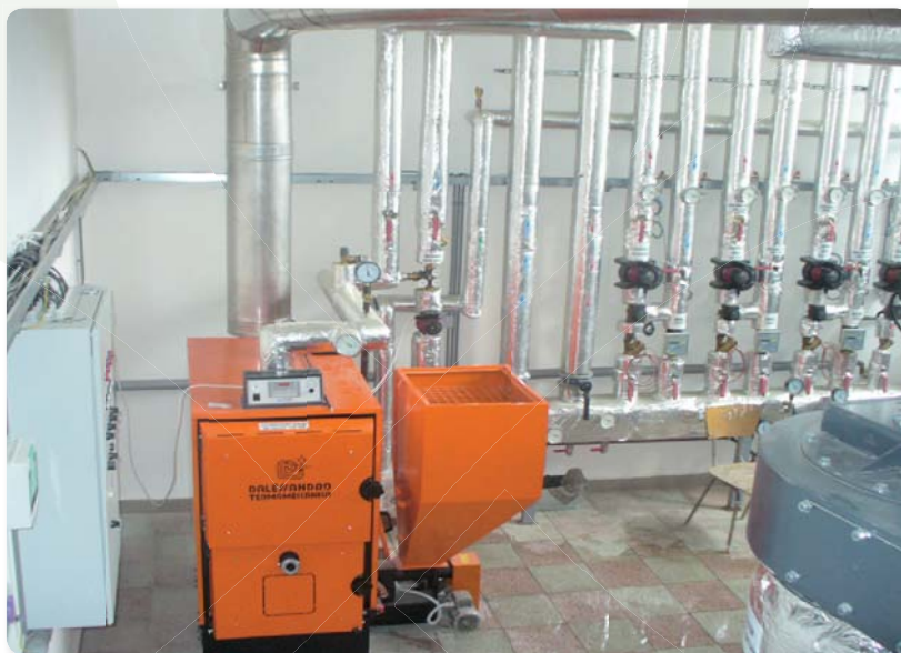
Technologické zariadenie kotolne na biomasu
