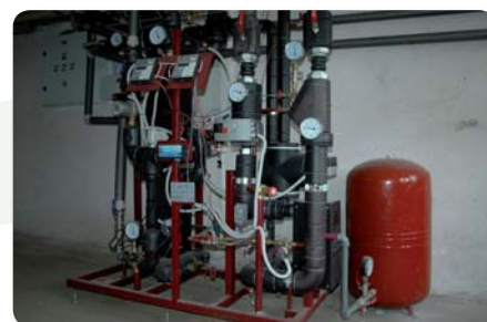
Technologické zariadenie kotolne
