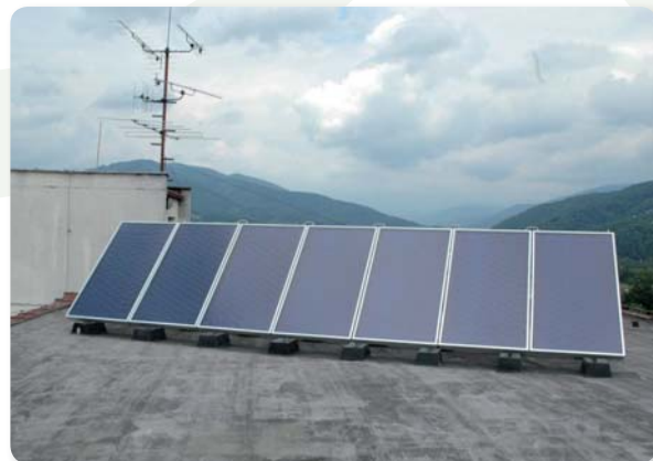
Inštalované solárne kolektory
