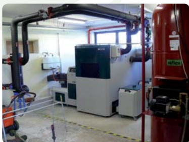
Kotolňa na biomasu v obci Poniky
