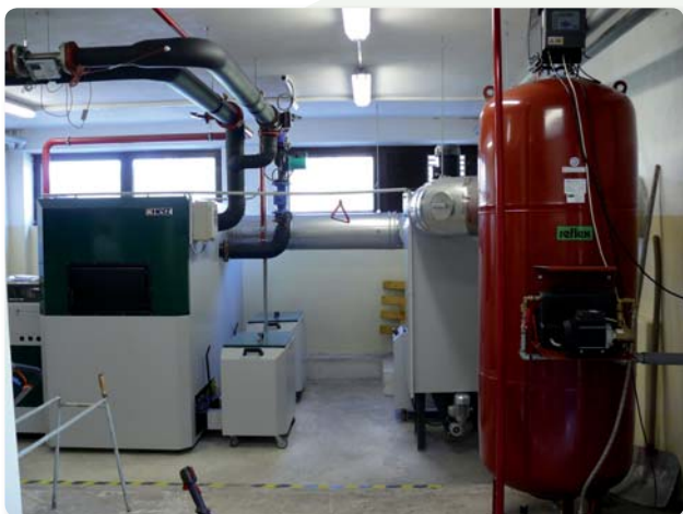
Pohľad na kotol na spaľovanie biomasy
